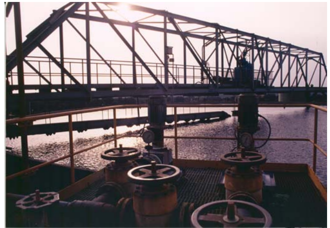
Espesador de lavado en contracorriente en la planta Quercus.
